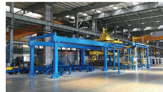
全自动铝棒装车系统 | Automatic aluminum rod loading system
