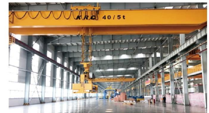
全自动智能天车系统 | Automatic intelligent crane system
